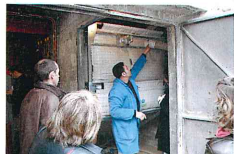
Visite d'une chaufferie (Source : CCI 48-30)
